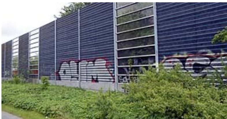
Støjskærm med graffiti, der skæmmer området
