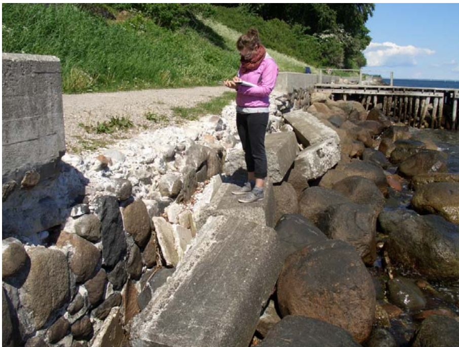
Figur 18: Stærkt nedbrudt betonavæg er brudt sammen.
