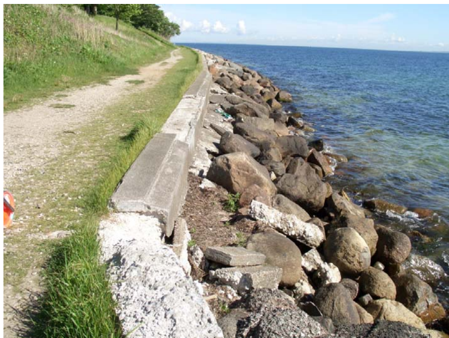
Figur 7: Ændring i murens højde og tilstand ved station 220.
