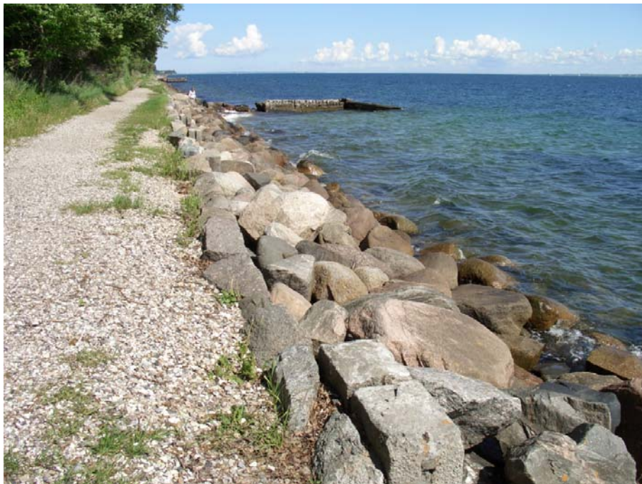
Figur 12: Oversigtsbillede af station 585 – 653 med nedbrudt badebro i baggrunden (station 640).
